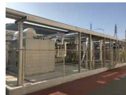
岡山工場のヒートポンプ
