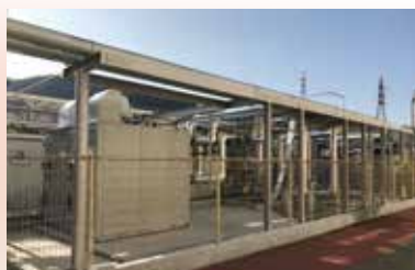
岡山工場ヒートポンプ設備
